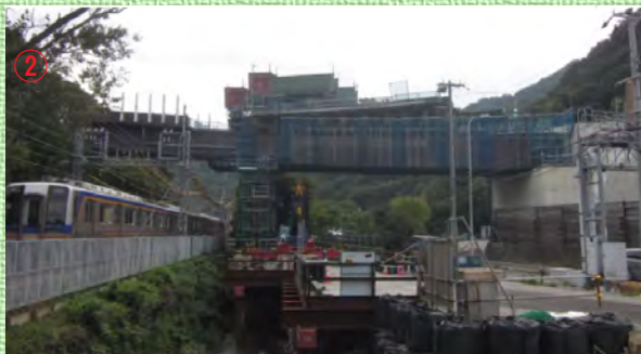
② 深日ランプ橋：南海電鉄上の橋桁が10月14日に送出と降下作業完了。引き続き床版を施工。
