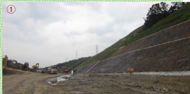
① 大谷地区：切土を進めており、11月末には切土が完了する予定
