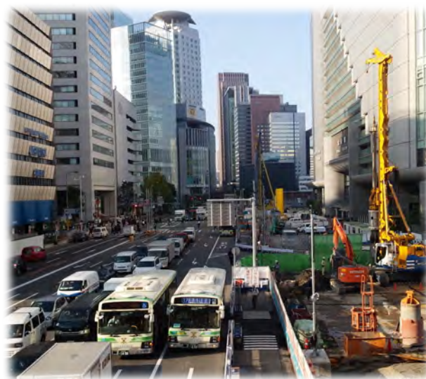
写真-2 道路占用状況
