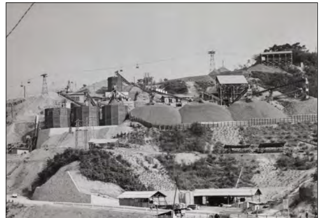
写真-9 ダム施工機械設備
