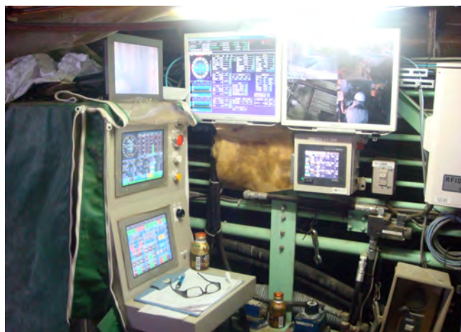
写真-1 シールド制御装置部
