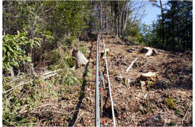
写真-5 光ファイバケーブル
