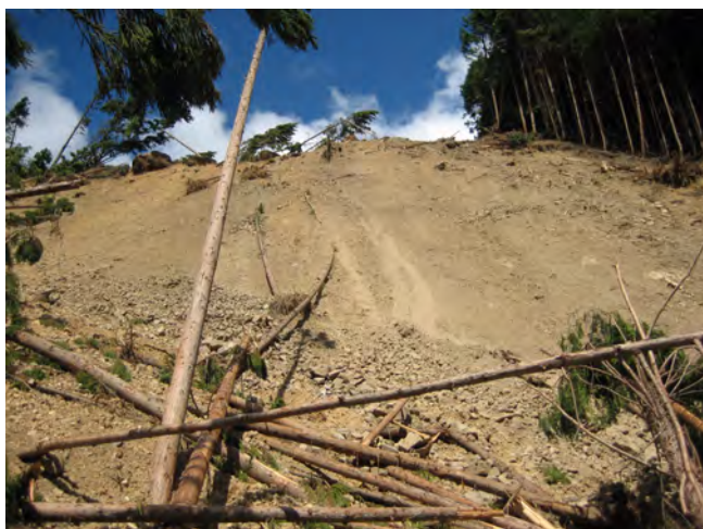
写真-1 崩落斜面全景
